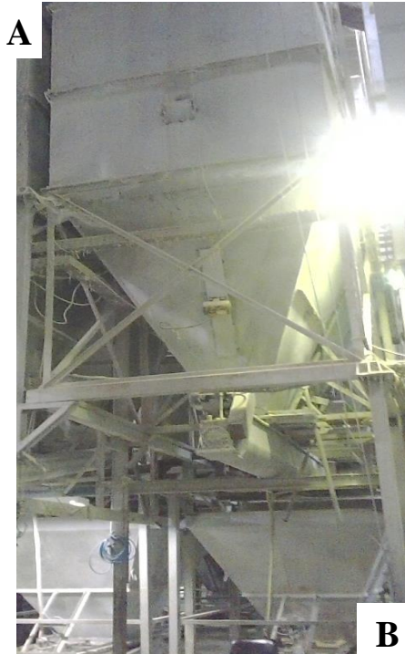
Figura 16 - Silo dosador (A) e Balança (B)
