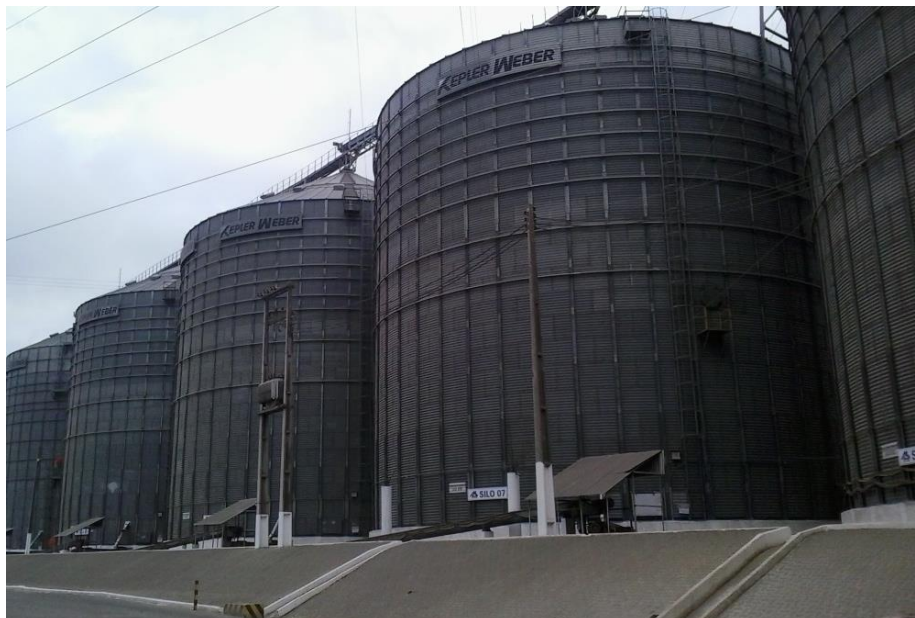
Figura 12 - Silos de armazenamento
