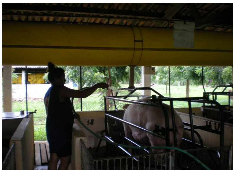
Figura 4- Sistema de resfriamento do galpão de maternidade
