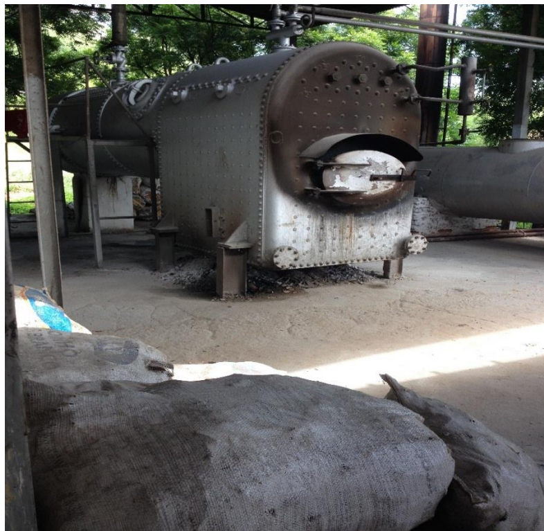
Figura 8 – Caldeira para aquecimento da peletizadora
