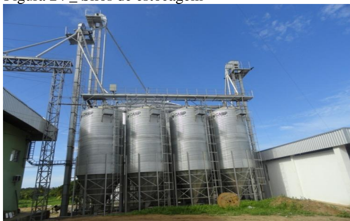
Figura 24 _ Silos de estocagem
